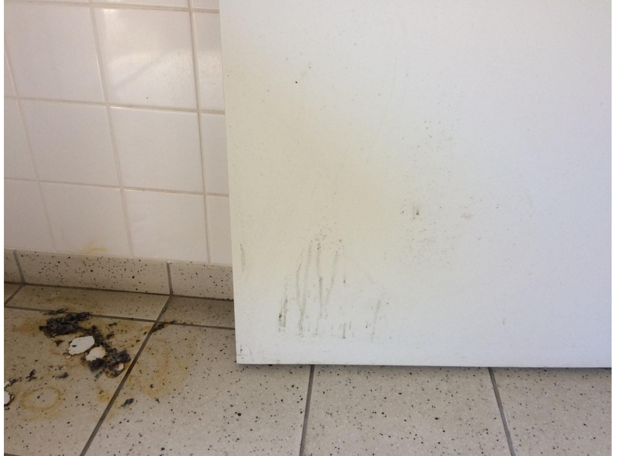
Détériorations WC extérieurs
