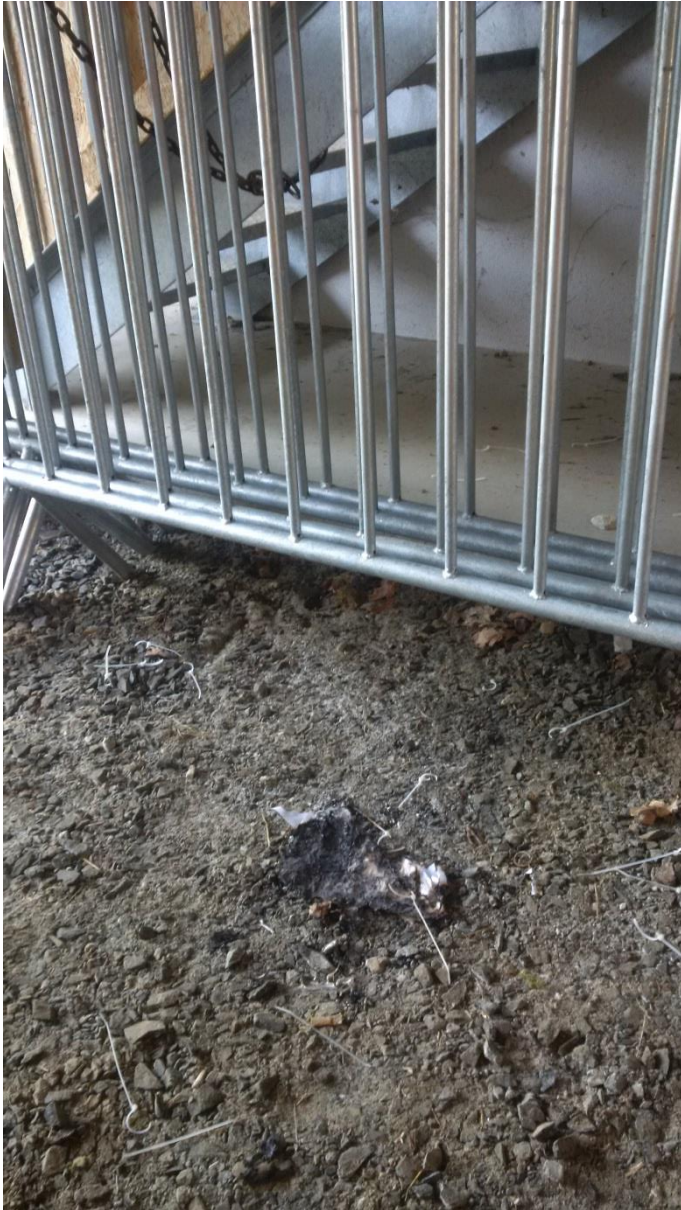
Détériorations Café du Commerce
